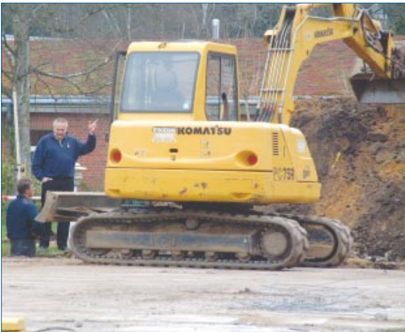
■ Die Baustelle im April mit Prof. Dr. Tamm (rechts) bei einer Baubesprechung
