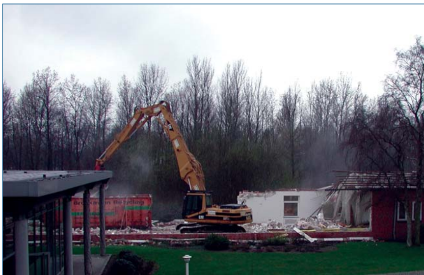
Die Arbeiten für den Neubau sind bereits in vollem Gange: hier der Abriss des A-Gebäudes
